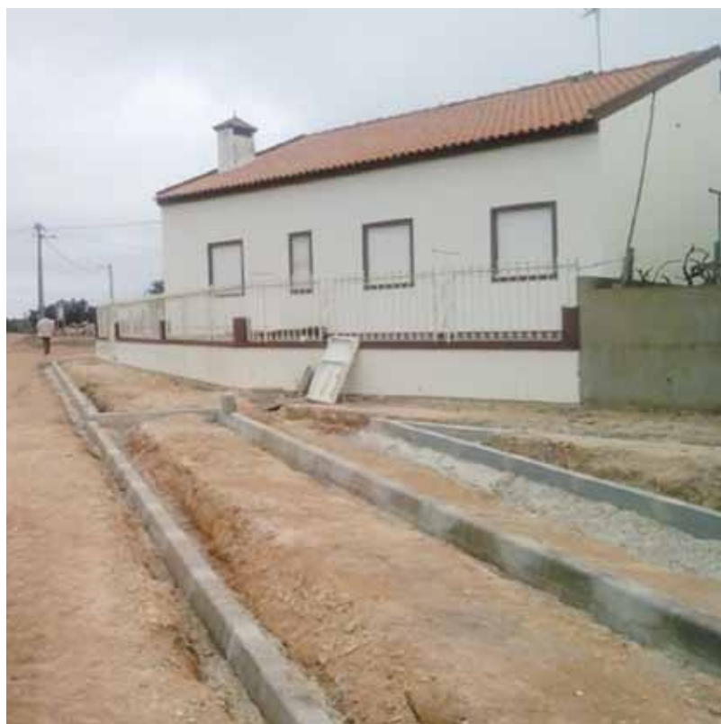
Execução dos arranjos exteriores na envolvente do Loteamento de Maria José Fonseca. Esta intervenção foi realizada em colaboração com a Junta de Freguesia da União de Freguesias de São Domingos da Serra e Vale de Água.
