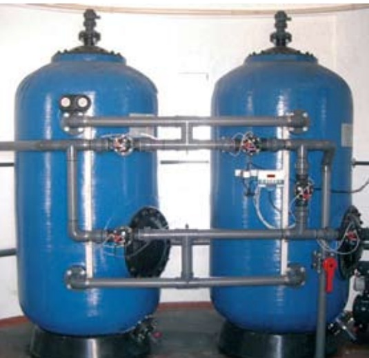
Vale de Água / Nova estação de tratamento de água equipada com tecnologia de ponta
