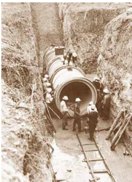
Figura 9 - Sifão do CCG do Alto Sado [Fotografia]. 1970.
